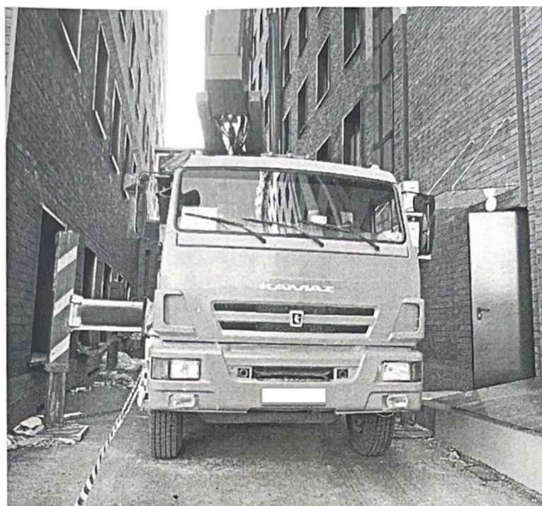
Рис. 2 Место установки подъемника во время произошедшего инцидента
