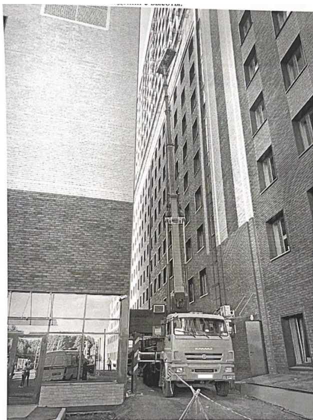
Рис. 1 Место установки подъемника во время произошедшего инцидента
